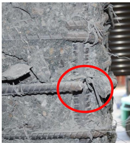
橫向鋼筋斷裂
