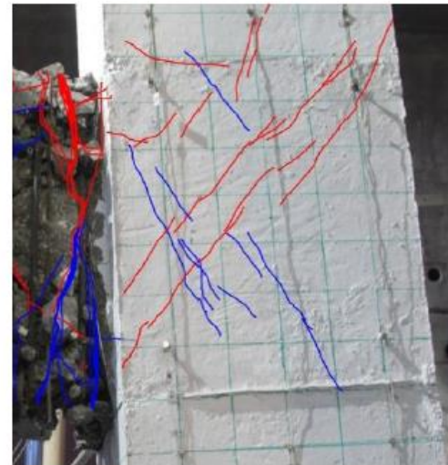
LAMV_SF 破壞時接頭處裂縫分布
