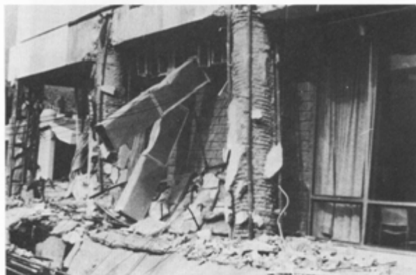
写真 4.15 同スパイラル柱の被害
