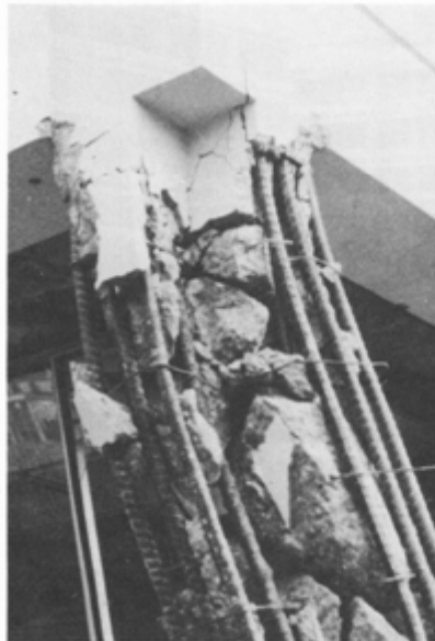
写真 4.14 オリーブビル病院の L形柱の被害
