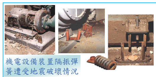
圖一 機電設備裝置隔振彈簧遭受地震破壞情況
