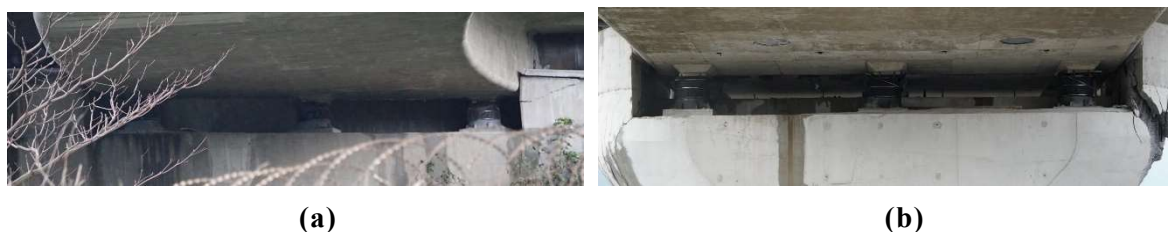
圖 24 七星潭大橋支承損傷狀況：
