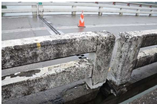
圖 11 花蓮大橋P12南下側橋面側移約15公分
