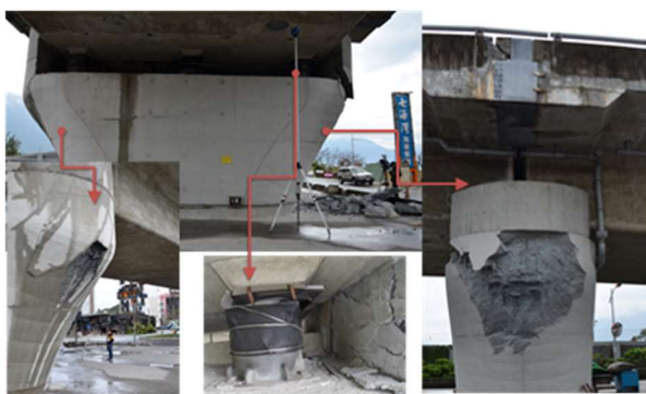
圖 21 七星潭大橋 P1 橋墩災損現況
