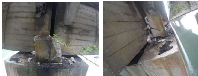
圖 14 花蓮大橋P12橫向止震塊損毀
