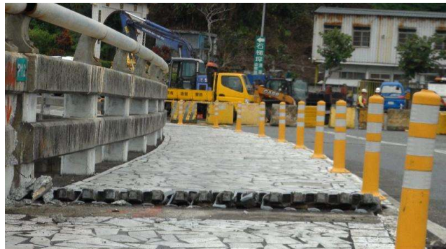
圖 12 花蓮大橋P12北上側伸縮縫處
