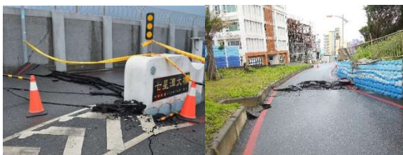
圖 17 七星潭大橋 A2 側側車道路面破裂
