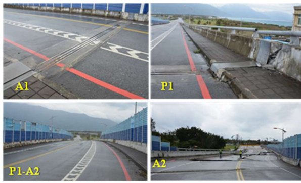
圖 22 七星潭大橋主橋橋面損傷情形
