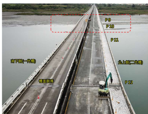
圖 13 花蓮大橋P9-P12橋面偏移情形
