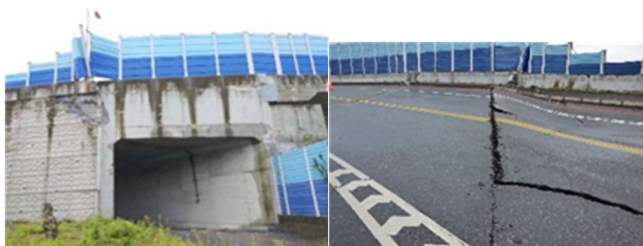
圖 19 七星潭大橋 A2 側箱涵損傷，涵洞後方路堤沉陷，隔音牆遭推擠變形
