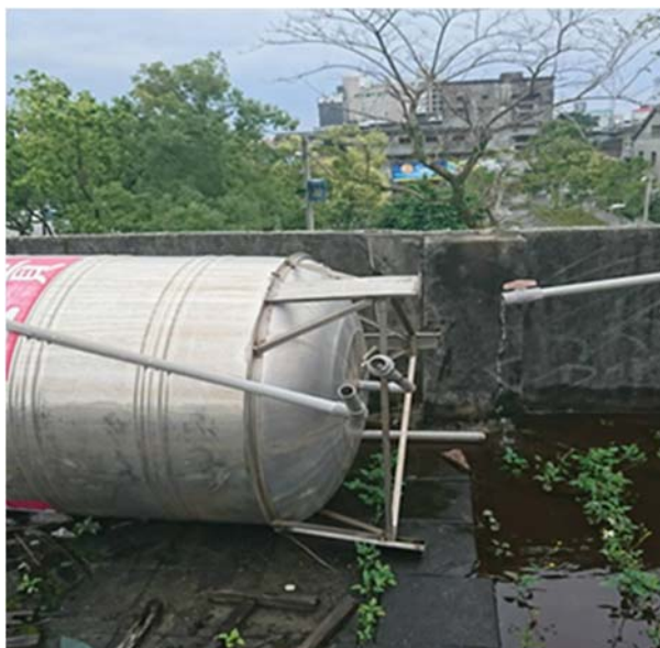
圖 16 民國樓頂樓水塔傾倒照[4]
