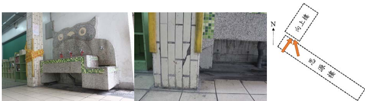
圖 27 思源樓二樓柱底震後出現斜向裂縫
