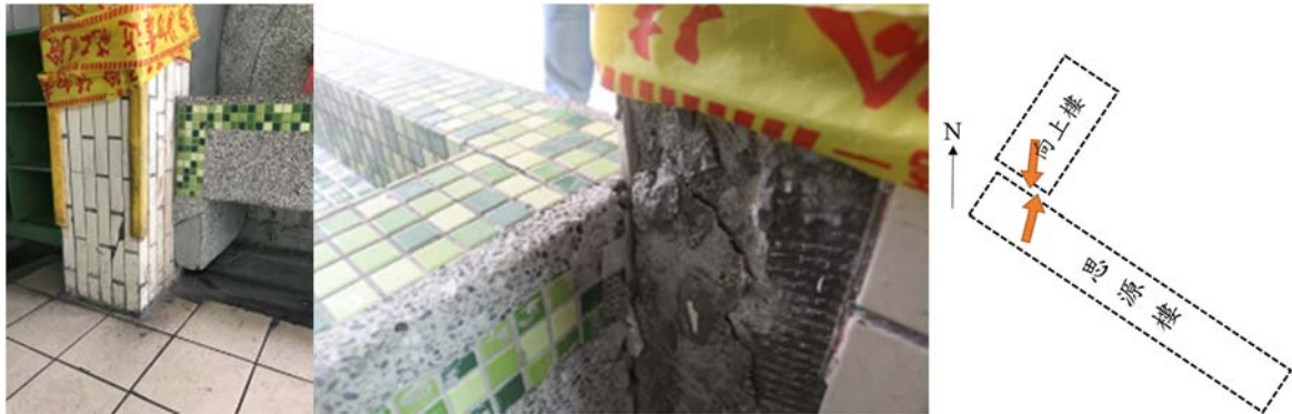
圖 28 二樓新設洗手台緊靠柱邊與震後產生之碰撞裂縫
