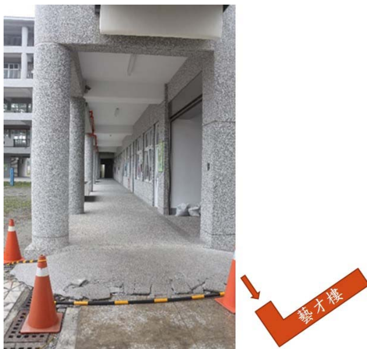
圖 15 藝才樓與仁愛樓一樓連接處坡道損壞
