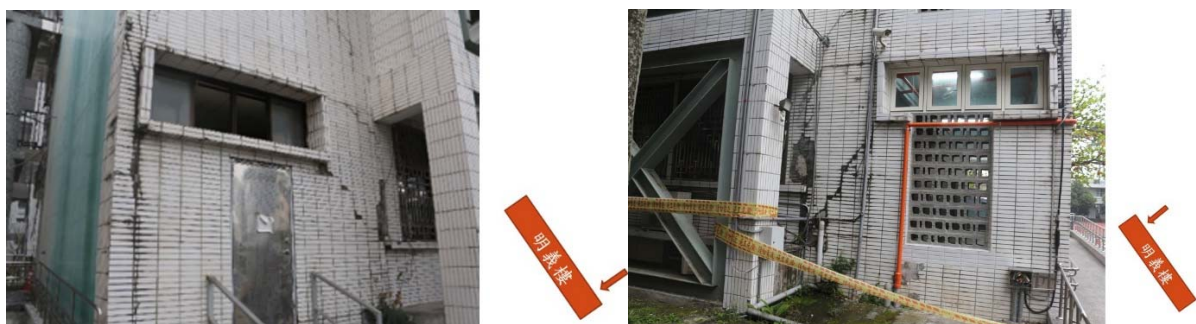
圖 21 明義樓 1F 左右兩側廁所磚牆損壞
