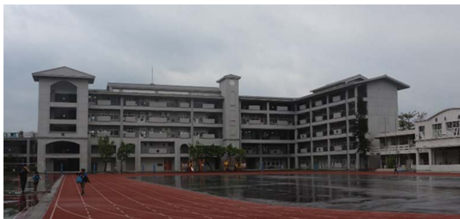
圖 14 藝才樓震後外觀照片
