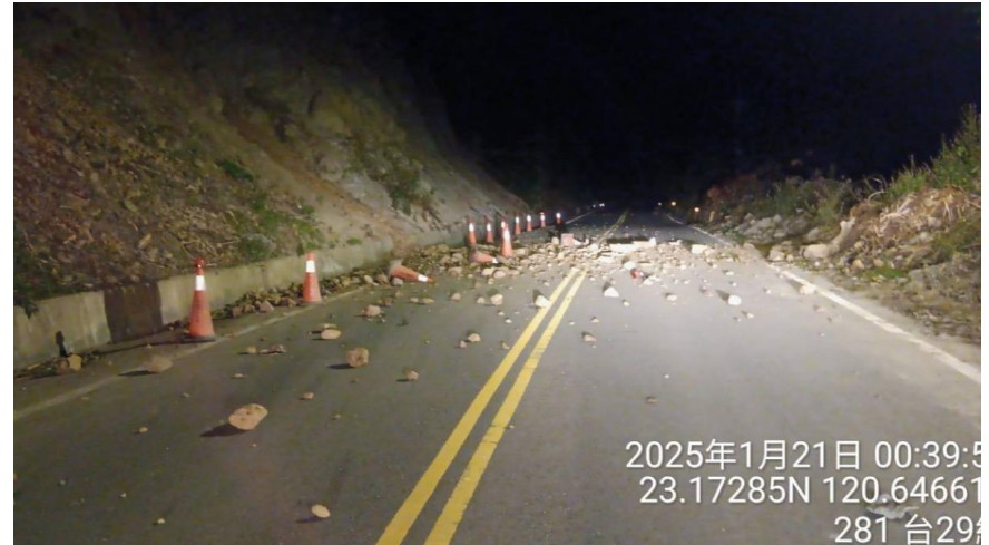
高雄市甲仙區台29臨11線便道7.5K邊坡大量落石。（圖／翻攝自南區養護工程分局）
