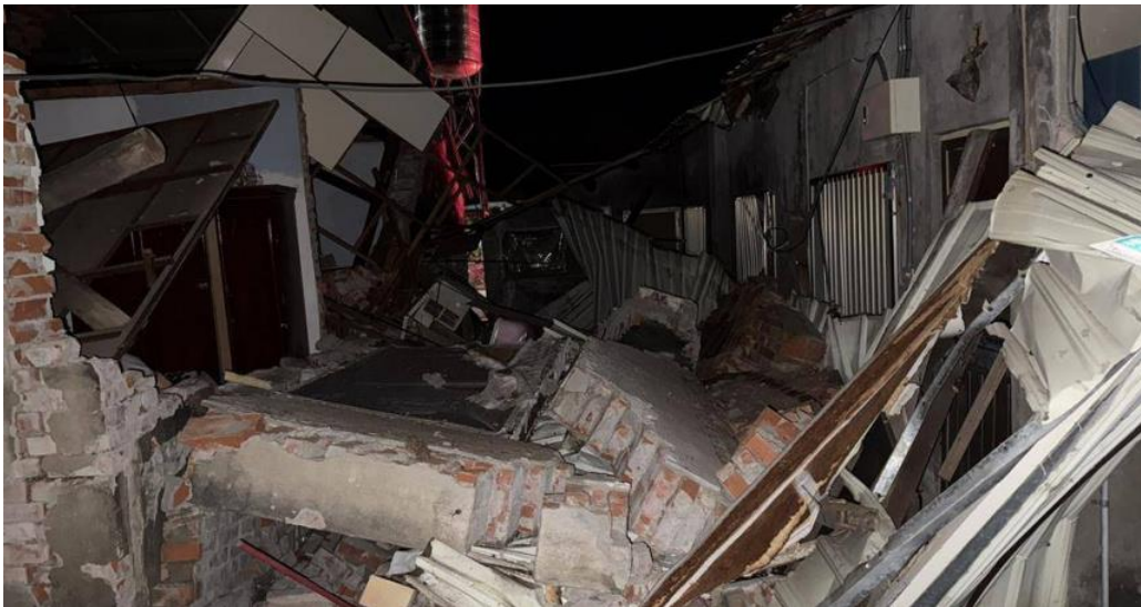
台南市楠西區民族路157巷一間平房被震垮。
