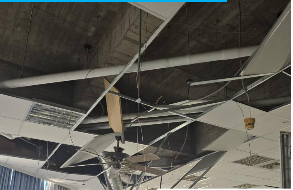
3F 天花板、燈具、風管、風扇掉落
