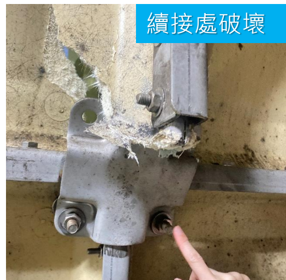
FRP槽壁撕裂
