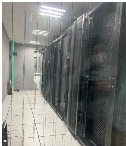
機櫃滑移撞破隔間牆
