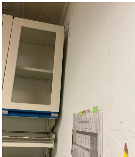
櫃體傾斜擦撞隔間牆
