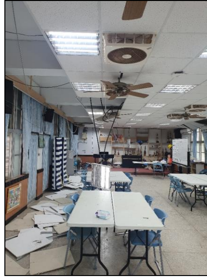
圖四十一 忠孝國小視聽教室天花板破壞情形。(PGA: 401 gal)
