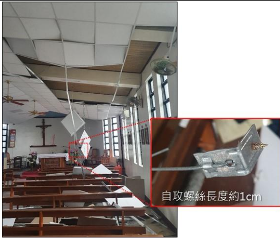
圖四十四 永福基督長老教會天主堂天花板破壞情形 (PGA: 336 gal)
