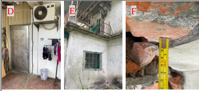
圖二十八 A：臥室樓板底部開裂；B：民宅前混凝土地坪裂縫；C：空心磚搭建外牆垂直貫穿裂縫；D：民宅與增建鐵皮屋間垂直貫穿裂縫；E：民宅一樓窗戶角落上下斜裂縫長達 1.1 公尺；F：磚牆下端向面外推移 5 公分。（PGA: 175 gal）
