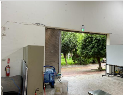
圖二十三 體育館入口處門框兩側頂角水平裂縫。(PGA: 401 gal)
