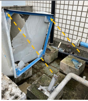
圖四十九 部立臺東醫院成功分院屋頂層空調系統膨脹水箱傾倒破裂 (PGA: 535 gal)
