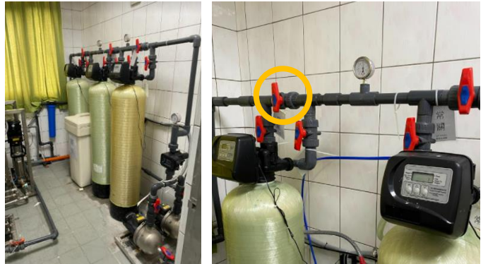
圖四十八 造水設備室內一覽（左圖）。濾心頂部相連之 UPVC 管線受震斷裂於圖中圈選處，勘災時已修復（右圖） (PGA: 535 gal)
