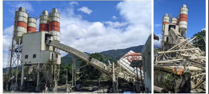
圖三十六 南側儲料桶與東側輸送帶支撐結構向西倒塌（左圖），西側輸送帶支撐結構則扭轉變形（右圖）（PGA: 175 gal）
