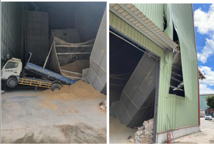
圖三十四 廠房西南側為車輛作業空間，東南側 15 公尺高滿載之粗穀槽向西倒塌時壓毀 2 輛卡車（左圖），並斷為兩截，上半部撞擊西側牆體導致結構變形、浪板外牆破損（右圖）。（PGA: 140 gal）
