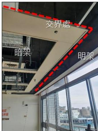
圖四十 明架與暗架天花板系統交界處破壞型式。(PGA: 535 gal)
