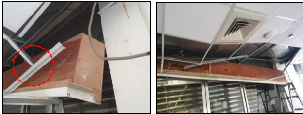
圖五十五 玉里醫院空調冷氣盒掉落導致天花板破壞 (PGA: 135 gal)
