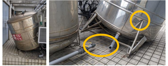
圖四十七 水塔向東南傾斜，桶身底部挫曲、腳座倒塌（左圖），水塔底部管線斷裂，焊接破壞之腳座悍件刺破桶身（右圖） (PGA: 535 gal)
