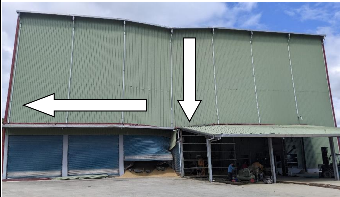
圖三十五 廠房結構鐵捲門間三支鋼柱向西歪斜，鐵捲門遭傾洩而出的粗穀擠壓產生面外變形，廠房西南半部整體向西偏移，並造成廠房南側屋頂中央受浪板拉扯產生 V 型沉陷。（PGA: 140 gal）
