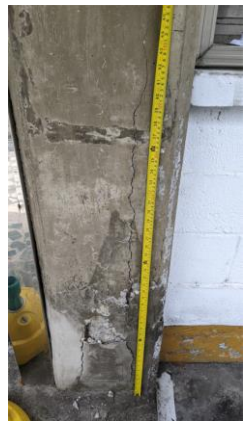
(b) 混凝土保護層脫落
