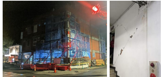
圖五十二 臺東消防成功大隊東河分隊結構補強工程施作當中。圖右為 1F 值班室外牆龜裂，門框變形致使門扇無法開啟使用 (PGA: 409 gal)
