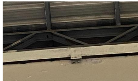
圖二十二 體育館正面牆疑似向東傾斜致與屋頂產生間隙 (PGA: 401 gal)
