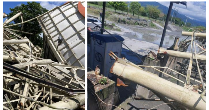
圖三十七 支撐圓柱上端受拉扯與儲料桶結構下端分離（左圖），西側四支圓柱有平整斷裂、轉接板變形、螺栓拔脫等震損（右圖）（PGA: 175 gal）
