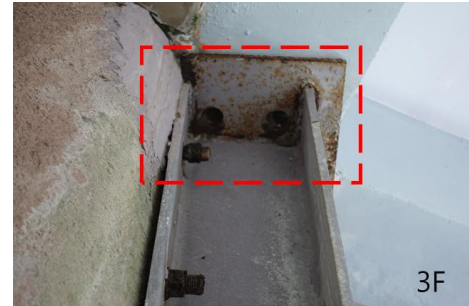
圖二十 成功國小西棟大樓三樓補強鋼柱上方螺栓脫落 (PGA: 515 gal)
