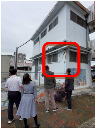
圖十七 臺東縣成功國小廁所受損外觀 (臺東縣政府提供)
