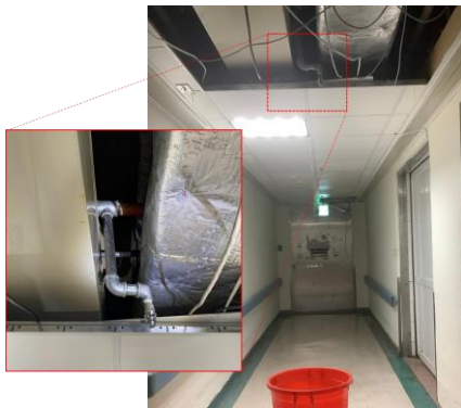
圖四十五 部立臺東醫院成功分院五樓廊道處消防撒水系統洩水 (PGA: 535 gal)
