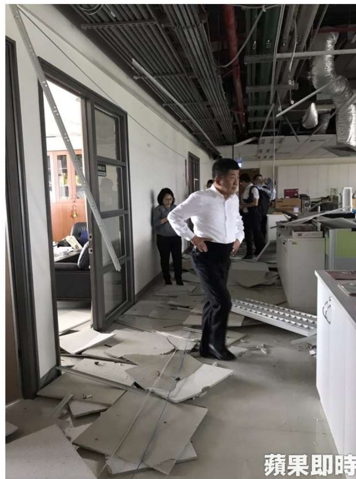
地震來襲衛福部大樓有部分處室輕鋼架天花板掉落。衛福部提供
