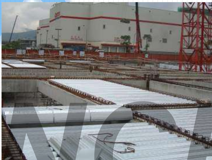
1. Deck進料大鋪
