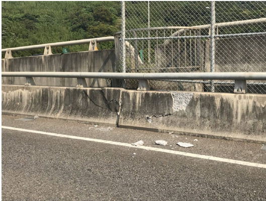
(1) 混凝土護欄接縫碰撞破裂損壞
