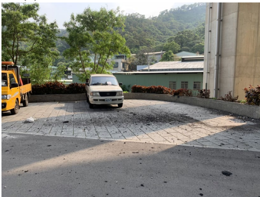
(3) 石塊掉落下方活動中心停車場
