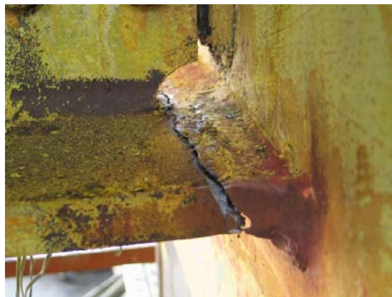
圖 4.2.1 梁翼板在腹板銲接扇形開孔尖端附近發生斷裂破壞
