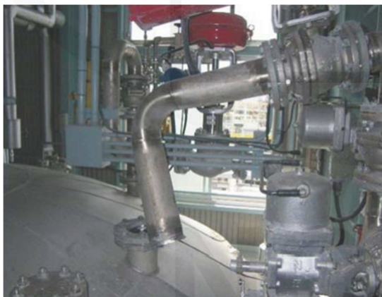
圖一 石化廠氫氣管線震損 (Wada et al., 2013)
