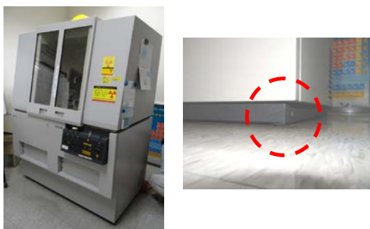
圖1 一般設備物未固定
