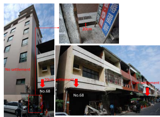
圖 6 聖安街街屋差異沉陷[2]
