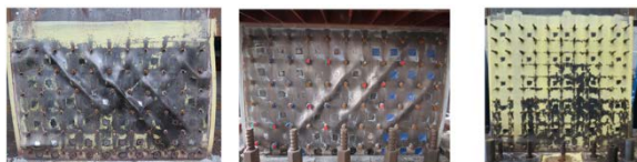
圖九 試驗終止時之牆體破壞狀態
