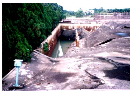
圖 1 豐原第一淨水場舊有 15,000\text{ m}^3 清水池震害
