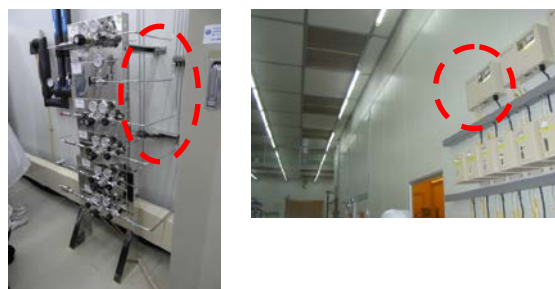
圖 15 設備物錨定於輕隔間牆上
