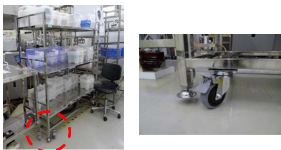
圖3 一般設備物貨架型式未固定
