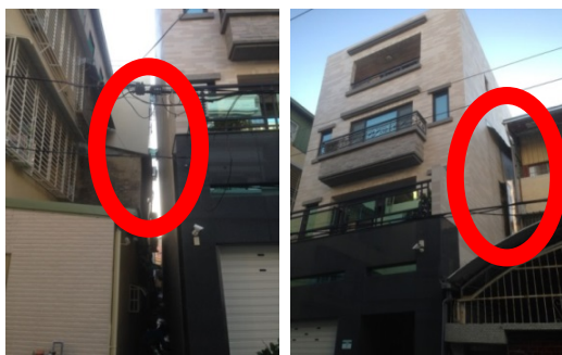
圖3 府安路街屋土壤液化房屋傾斜
