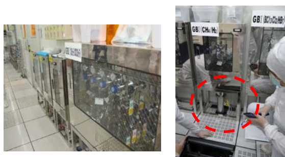
圖 13 靠牆設立之管線座需固定
