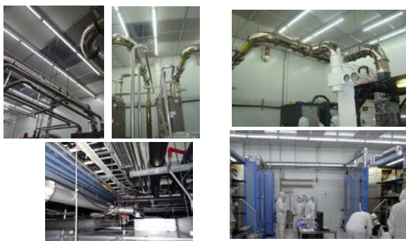
圖 14 天花板懸吊管路與儀器
