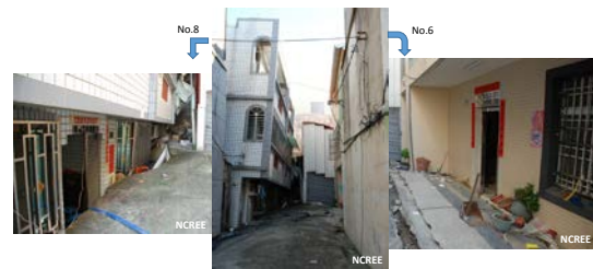
圖 4 惠安街街屋土壤液化下陷傾斜[2]
