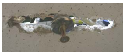
圖 7 天花板 X 向損壞圖
