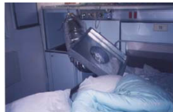
圖1 九二一震災中部醫院病房空調出風口掉落(姚昭智教授提供)
