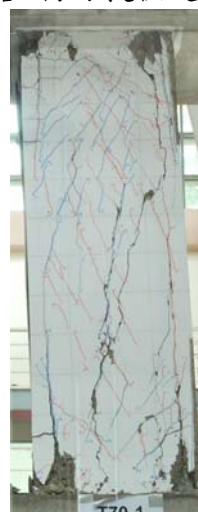
圖3 試體 T70-1 於層間位移比為 3% 時裂縫發展照片
