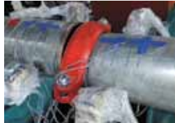
圖 10 撓性機械接頭破壞情形
