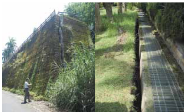
圖三 鹿谷國中擋土牆破壞案例（左：翼牆開裂；右：牆體與背填土分離）
