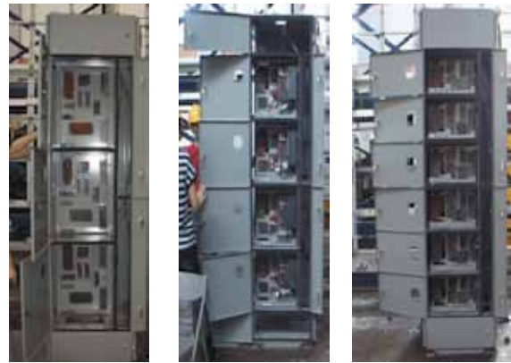
(a) 600 型 (b) 450 型 (c) 300 型 圖二 電氣盤體機櫃之盤內設備配置
