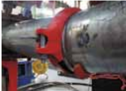
圖 9 剛性機械接頭破壞情形
