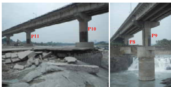
圖一 舊中正橋受冲刷情况(2012年8月攝)
