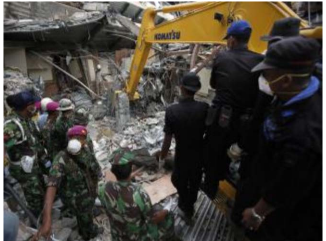
圖九 開挖倒塌建築搶救之現場情況 (達智影像/美聯社)
