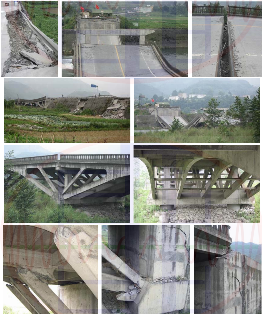
圖十六：彭州小魚洞大橋之破壞情形
