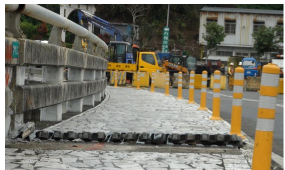
圖十四 花蓮大橋P12北上側伸縮縫處
