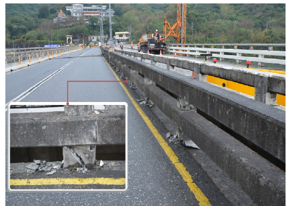
圖十二 P9到P10間北上側二代橋上游側之RC橋護欄全數剪壞
