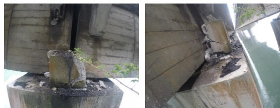
圖十六 花蓮大橋P12橫向止震塊損毀
