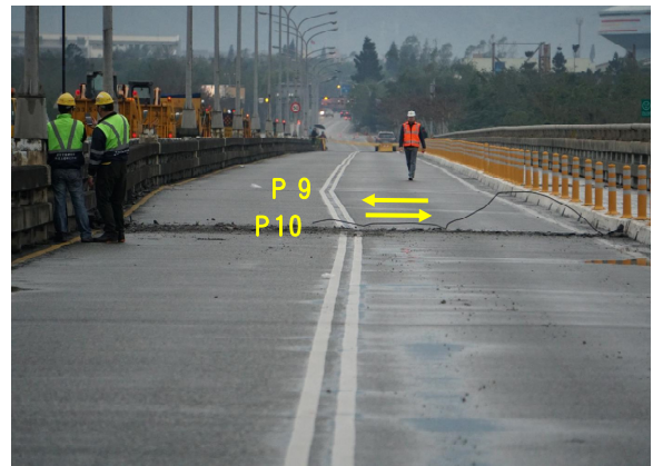
圖十一 花蓮大橋P9和P10處橋面側移旋轉
