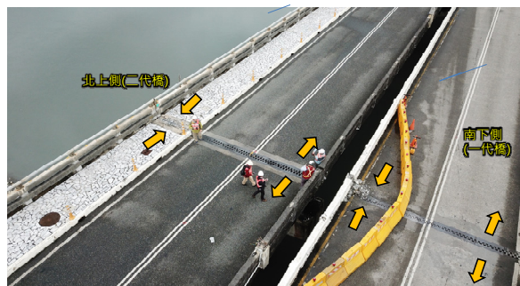
圖十 花蓮大橋P9橋面伸縮縫損傷(林正偉攝)
