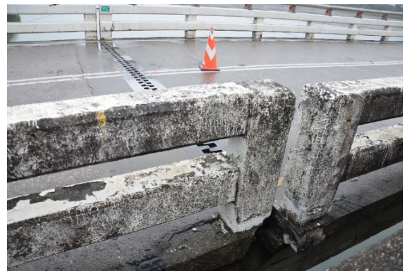
圖十三 花蓮大橋P12南下側橋面側移約15公分
