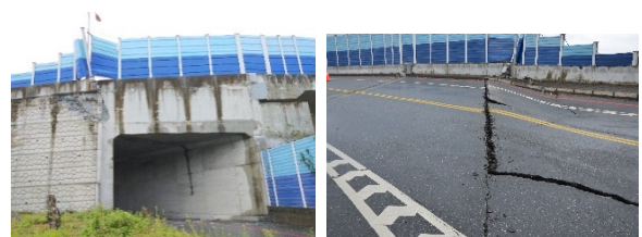
圖二十四 七星潭大橋A2側箱涵損傷，涵洞後方路堤沉陷，隔音牆遭推擠變形
