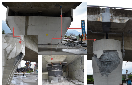
圖二十六 七星潭大橋P1橋墩災損現況
