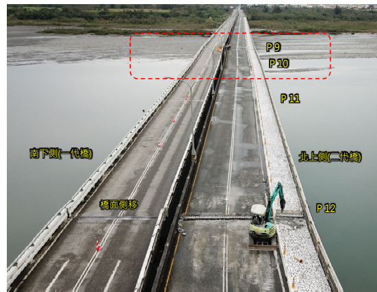
圖十五 花蓮大橋P9-P12橋面偏移情形(林正偉攝)
