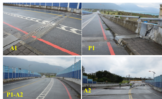
圖二十七 七星潭大橋主橋橋面損傷情形
