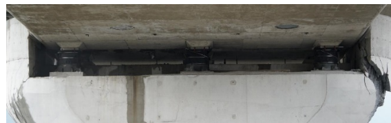
(b) P1橋墩支承側向位移，側向止震塊震損
