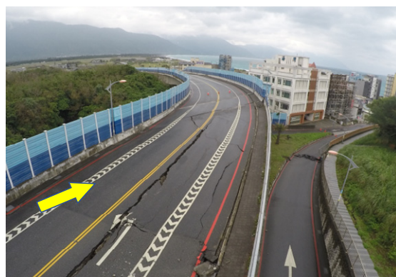
圖二十八 七星潭大橋A2橋台後方引道路堤受損
