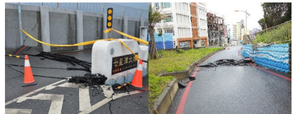
圖二十二 七星潭大橋A2側側車道路面破裂
