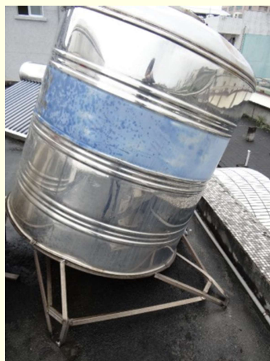
水塔支架變形
