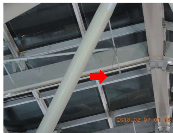
中庭挑空消防撒水管懸吊線鬆脫
