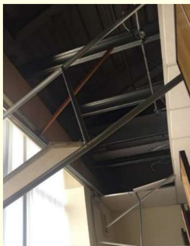
未正確設施吊線
