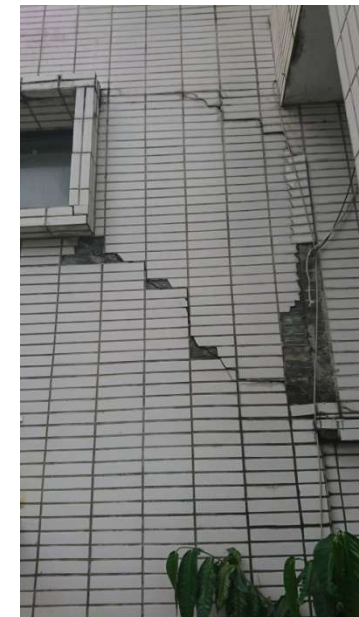
結構損壞-明義國小明義樓
