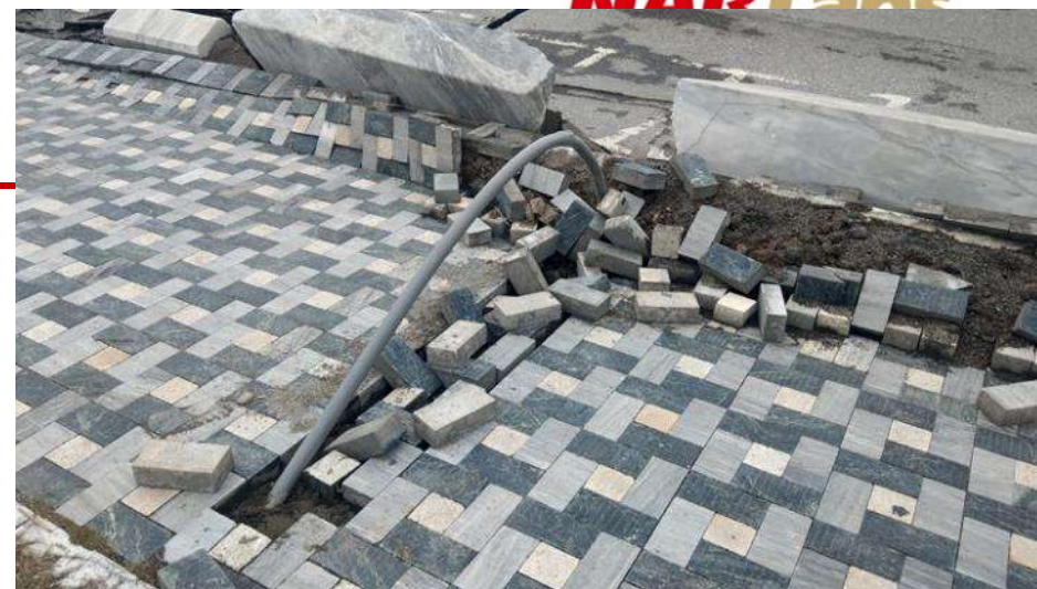
停車場供水管線受震擠壓突出地表
