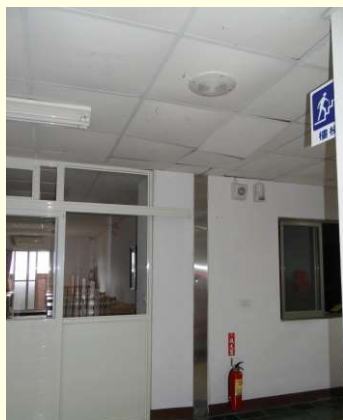
海星高中宿舍 天花板掉落
