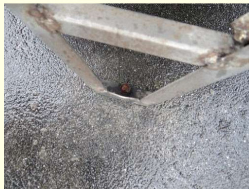
錨定情況(螺栓鏽蝕)
