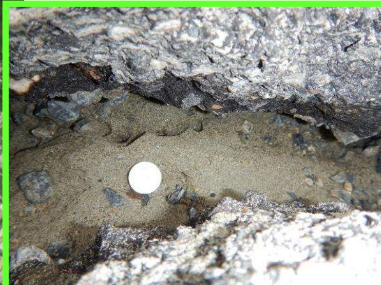
華西路鋪面下方土壤液化
