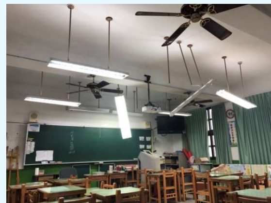
中華國小教室燈架脫落情況
