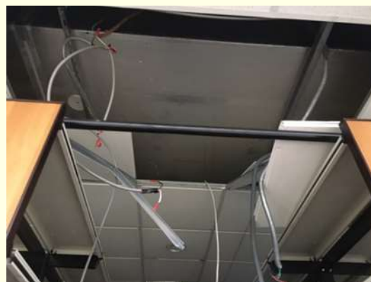
管線無吊線、燈具掉落
