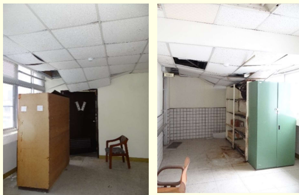
天花板系統末端鄰近牆面處破壞
