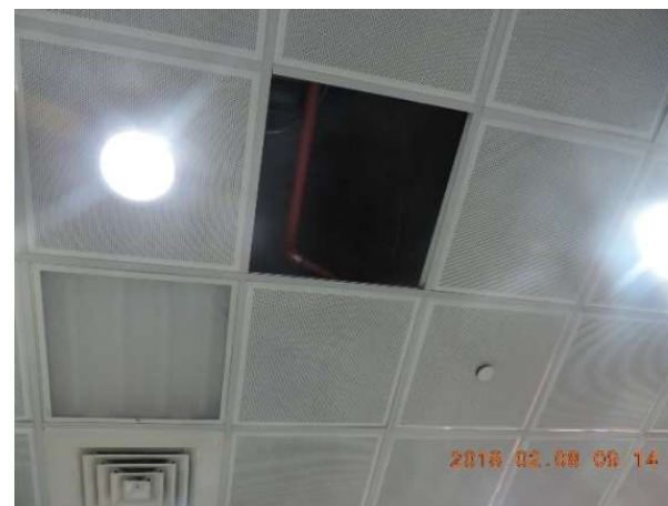
沖孔金屬天花上方消防撒水管漏水
