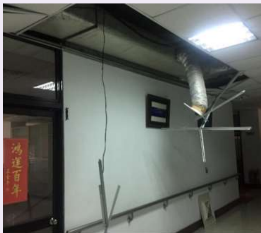
走廊天花板受損
