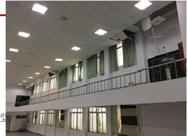
非結構損壞-美崙國中活動中心
