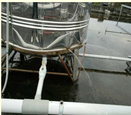
水塔底部變形漏水
